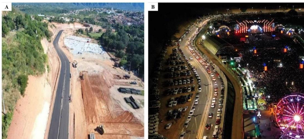
Figura 6: Antes e depois das modificações realizadas para abertura da Rua Major José Gonçalves, Crato-CE.
